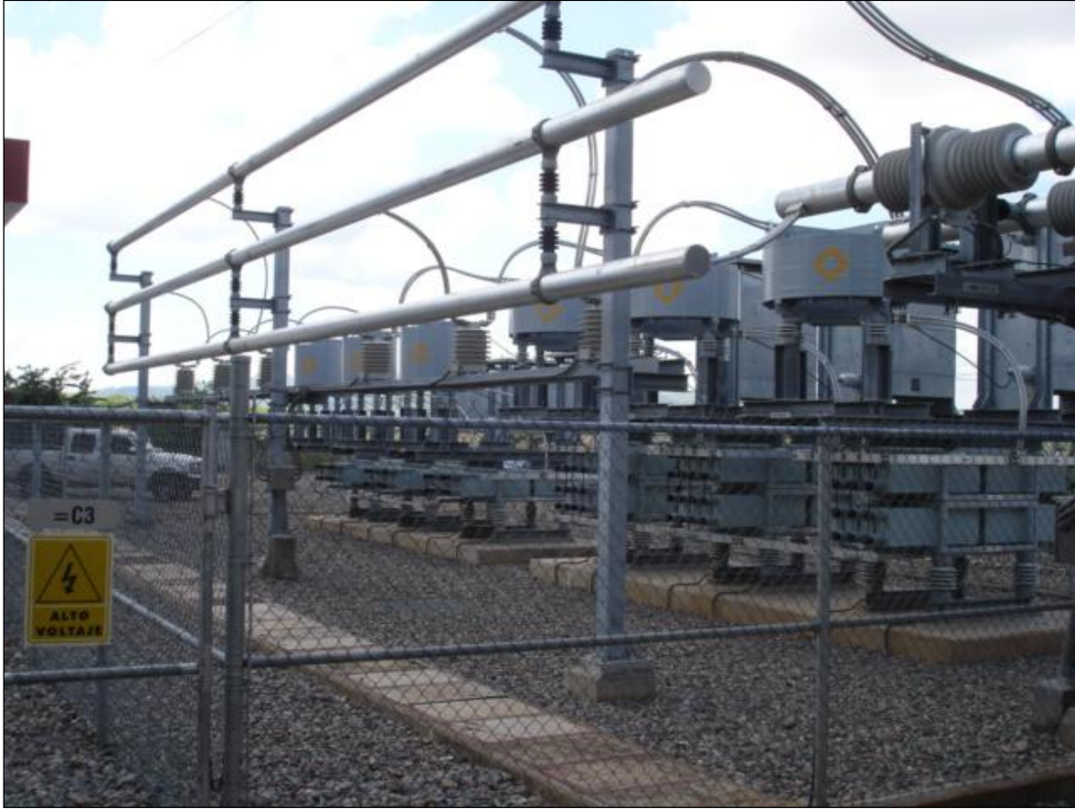
Figura 3.14 Fotografía de los filtros de 5ta y 7ma armónicas del CEV de CUT.
