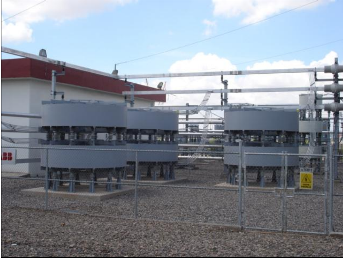
Figura 3.9 Fotografía de los reactores de la rama TCR del CEV de CUT.
