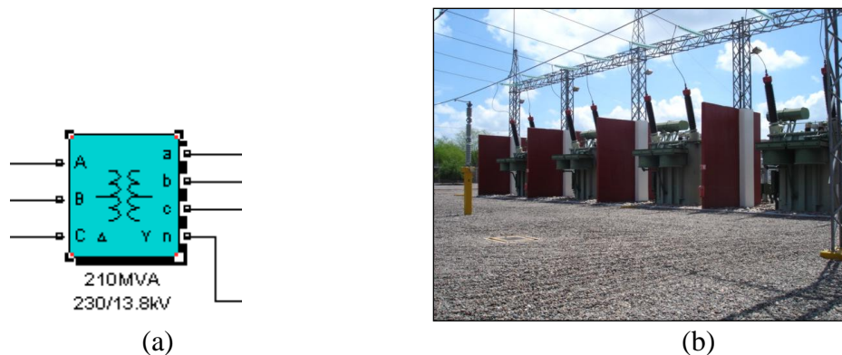
Figura 4.4 Modelo Simulink del transformador utilizado (a) y transformador del CEV (b).
